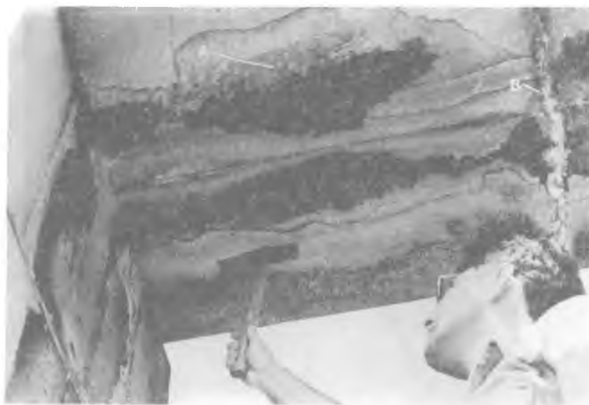
Сл. 7. "Тамна кора" настала таложењем чврстих честица из атмосфере. Ефлоресценција дуж спојница блокова. Fig. 7. "Dark crust" caused by atmospheric pollution. Efflorescences along the mortar joints.
