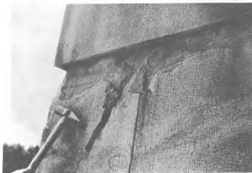
Сл. 5. Комадасто распадање блокова. Fig. 5. Cracking of blocks.
