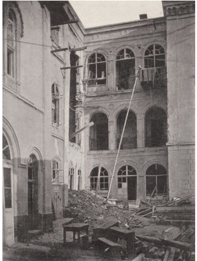
Fig. 13. The damage of the Geological institute after bombing campaign in 1914 (after STANOJEVIĆ, 1915). Сл.13. Последице бомбардовања 1914. године (STANOJEVIĆ, 1915).
